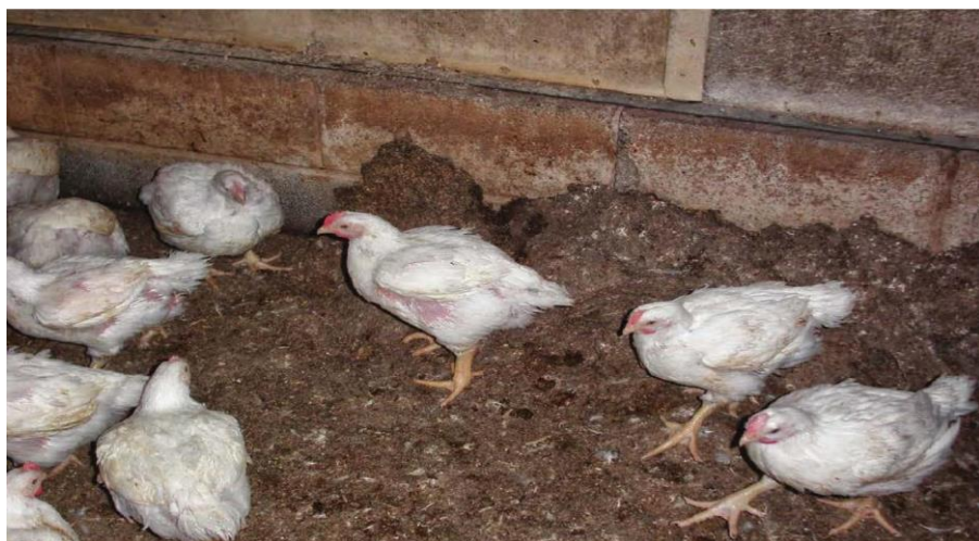
شکل ۴-۹ تمیز کردن ضعیف سالن‌ها خطر بروز بیماری در بین دوره‌های مختلف پرورش پرندگان را افزایش می‌دهد. در ساختمان‌های قدیمی با کف‌های ترک‌خورده، دیوارهای ناصاف و نازک و سازه‌های چوبی، تمیز کردن و ضدعفونی کردن بین دوره‌ها بسیار دشوار است.
