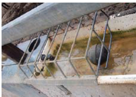
شکل ۶-۷- شناور کنترل آب همراه با حفاظ
